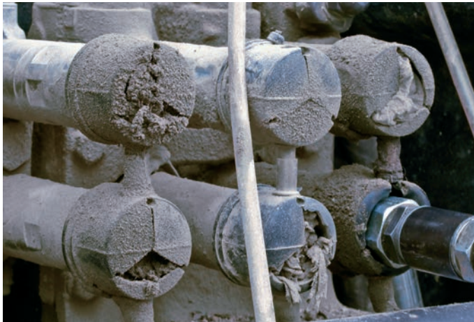
Staubauflagerungen in einem Industriebetrieb
