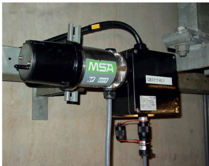
Anwendungsbeispiel: Gaswarngerät mit steckbarem Anschluss über eine Anschlussdose in einer Abwasseraufbereitungsanlage
